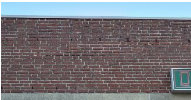
Figuur 4: Open stootvoegen in de westgevel
