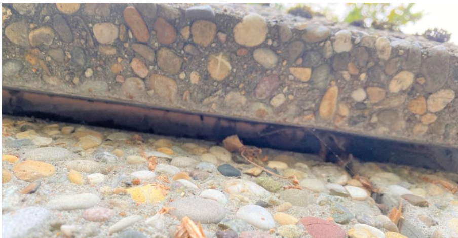
Figuur 4.4.3. De kieren tussen de gevels en het dak zijn te tochtig voor vleermuizen.
