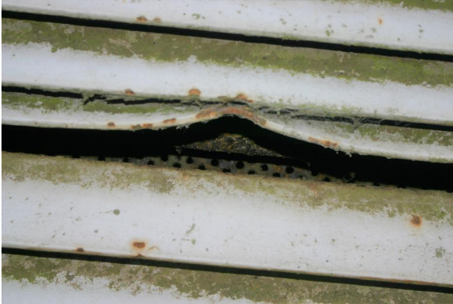
Figuur 4.4.2. Achter de ventilatieroosters zitten roosters met een zeer nauwe maaswijdte waardoor er niets naar binnen kan.
