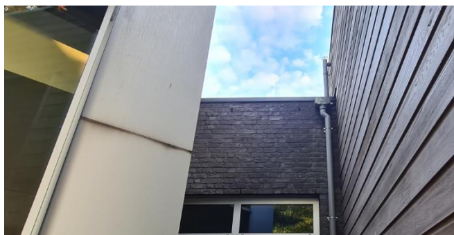
Figuur 7: Open stootvoegen in de westgevel
