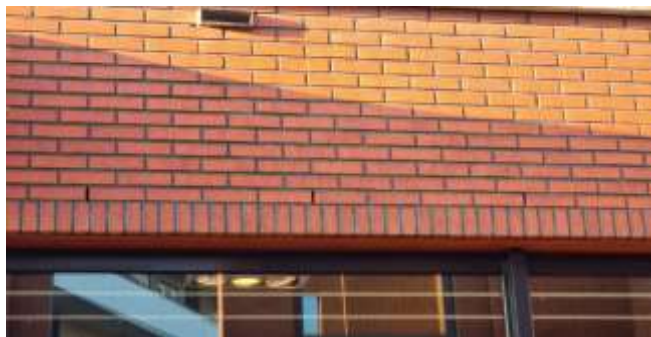
Figuur 7: Open voegen in gevel aan de Corridor
