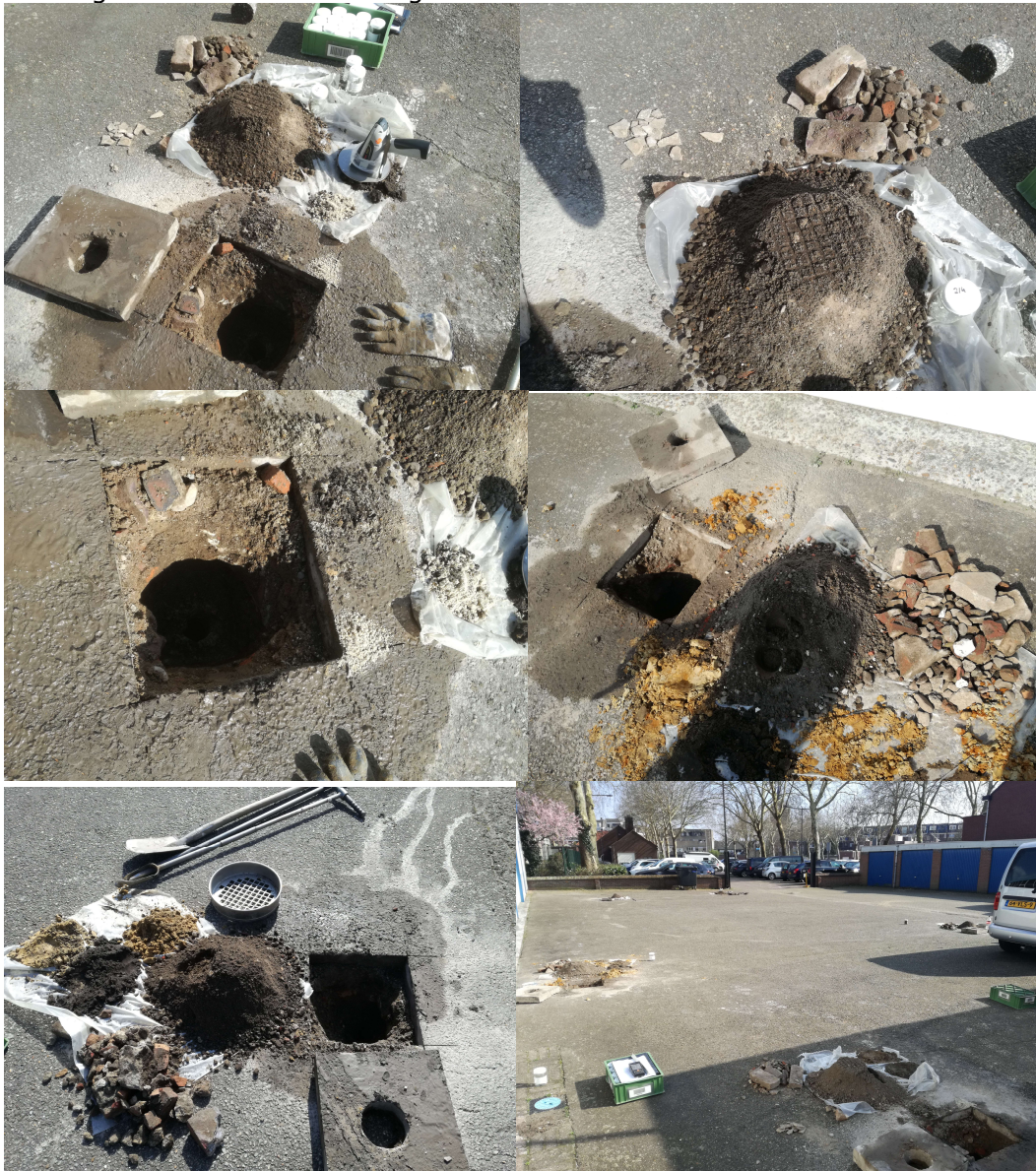
Asbestgaten in asfaltverharding
