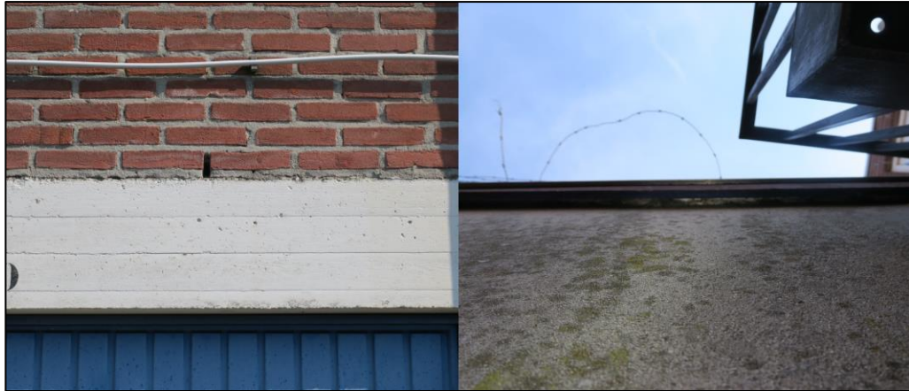
Figuur 4 openstootvoegen en kierende kantpannen aan de zuidgevel bieden toegang tot de spouw.
