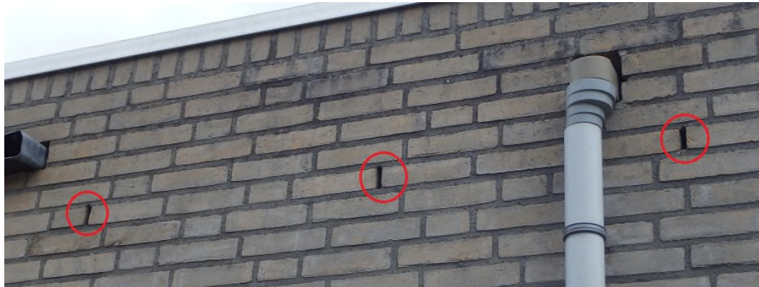
Afbeelding 5.5. Spouwmuurgaten aan de oostzijde van binnenzwembad “De Wedert”.
