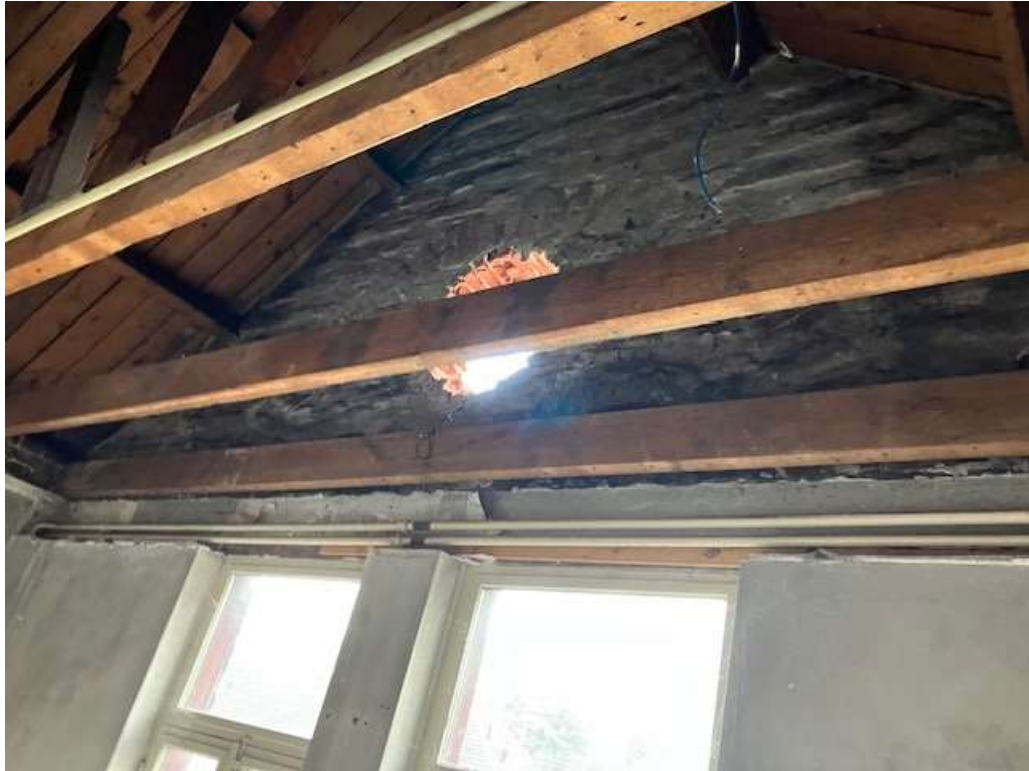
• Afbeelding 24: Zolder discotheek, steens muren, geen glas meer in het raampje in te top
