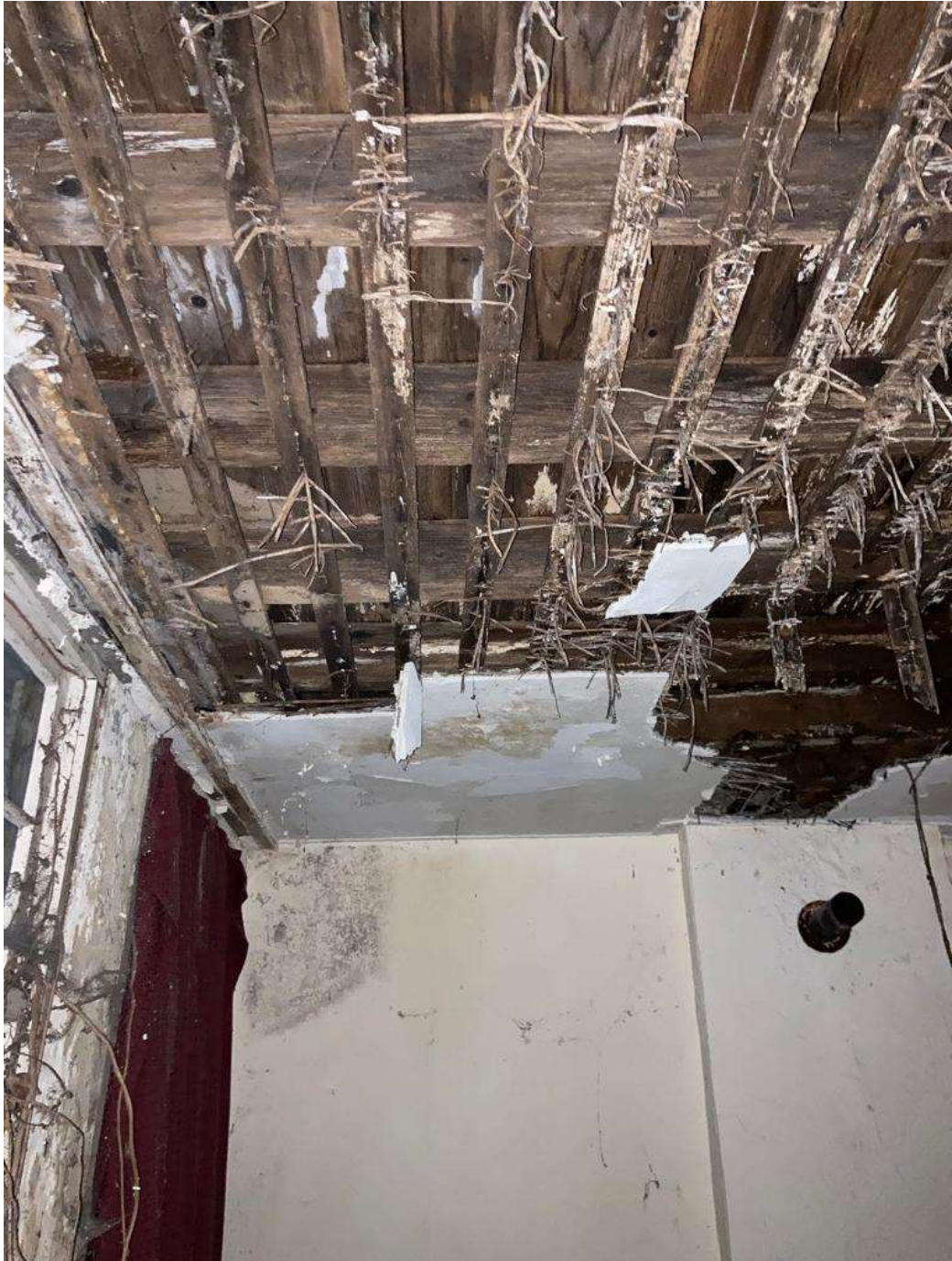
• Afbeelding 25: door vocht stukwerk van plafond
