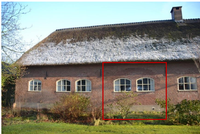
Voorgevel van het bedrijfsdeel. Het inboetwerk is rood omkaderd.
