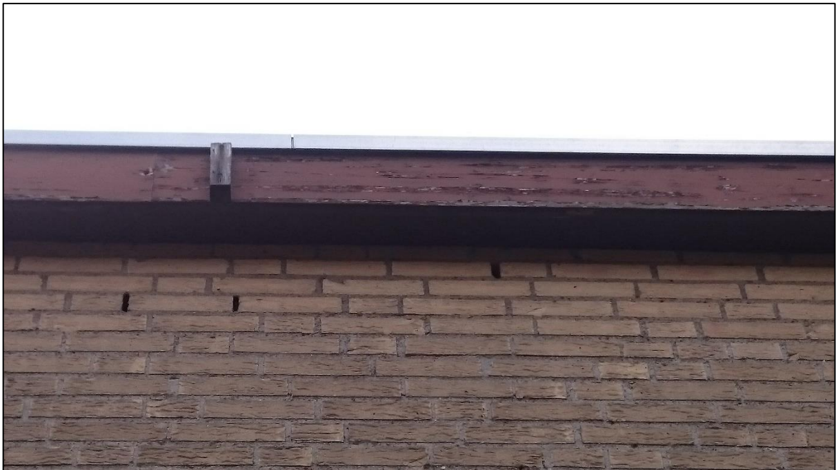
Afbeelding 5: Stootvoegen in de rechterzijde van woningblok E.
