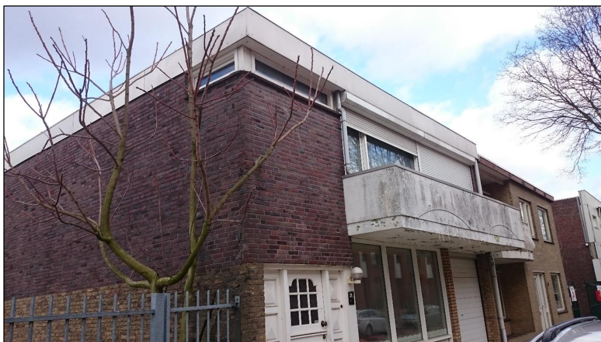
Foto 7: Linker gedeelte van woningen E. Geen stootvoegen aanwezig
