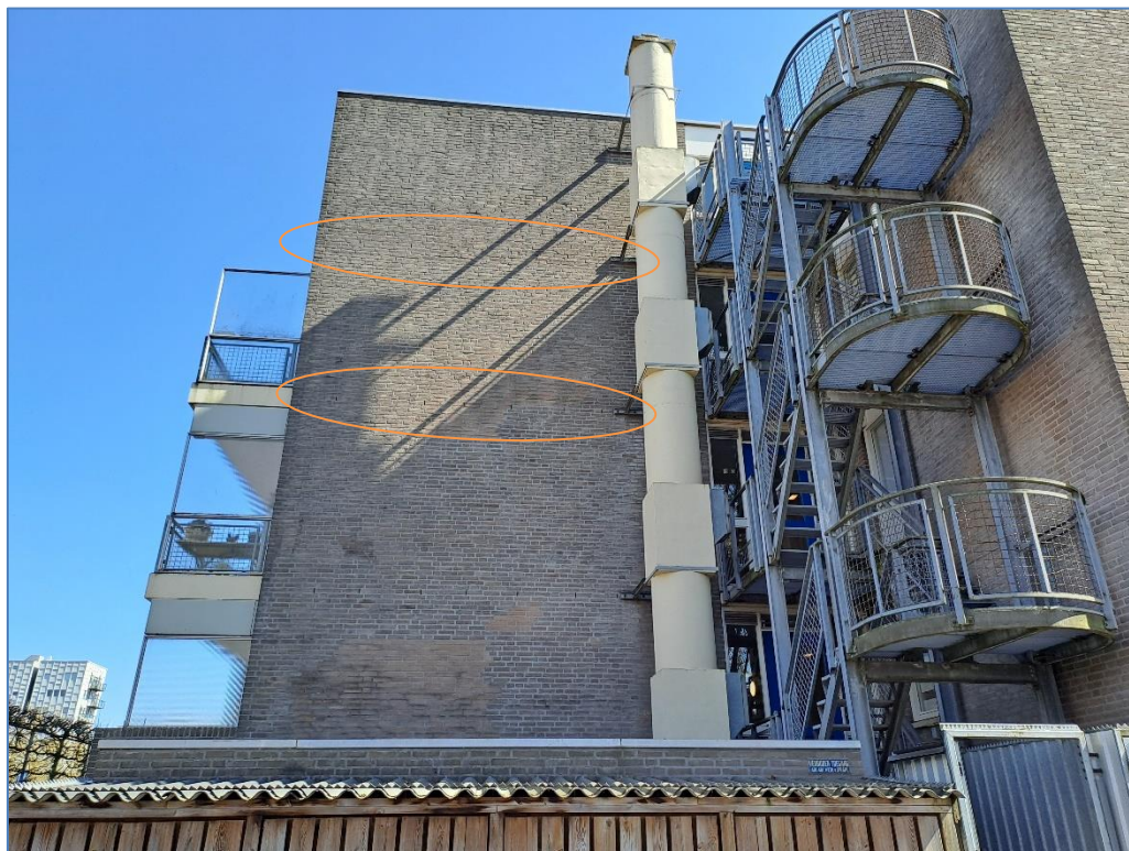
Afbeelding 5. Zicht op de westgevel van het appartementencomplex, stootvoegen weergegeven in oranje cirkels.
