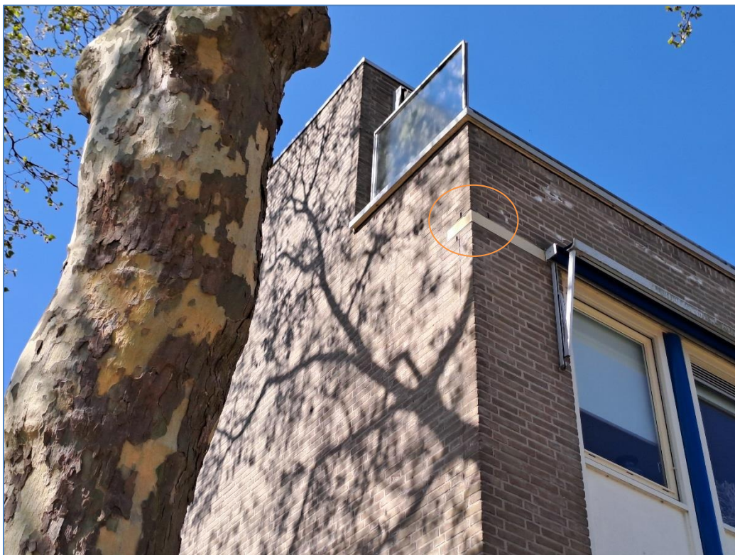
Afbeelding 11. Zicht op het appartementencomplex, stootvoegen weergegeven in oranje cirkels.
