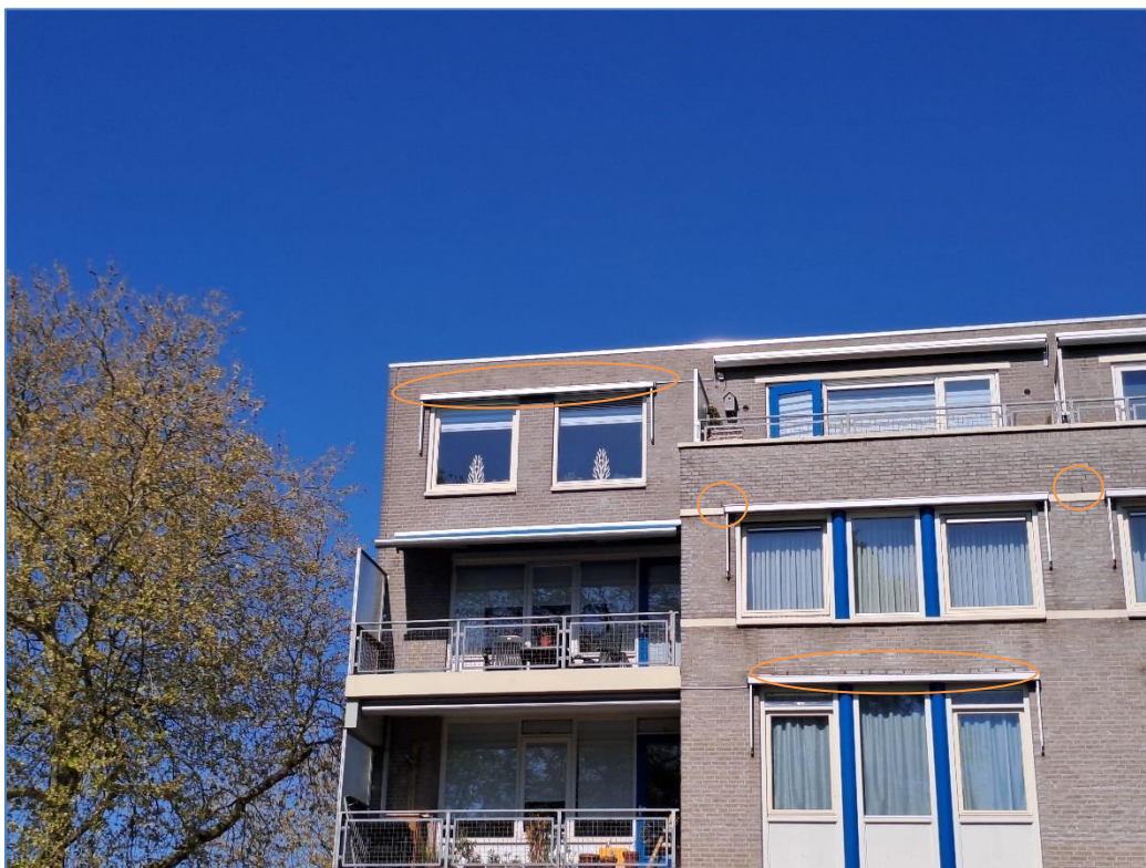
Afbeelding 12. Zicht op het appartementencomplex, stootvoegen weergegeven in oranje cirkels.
