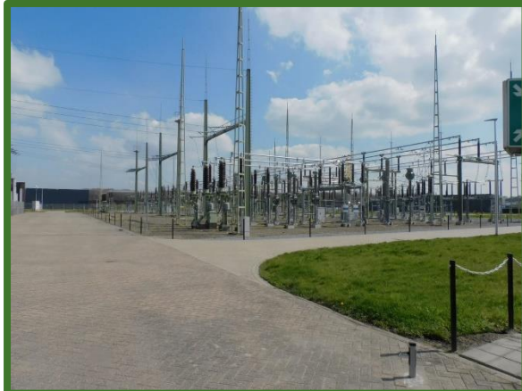
Overzicht huidige hoogspanningsstation
