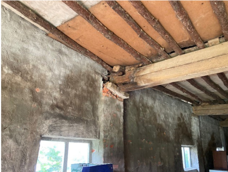
Door inwatering zwaar aangetaste trekbalk in de westgevel.
