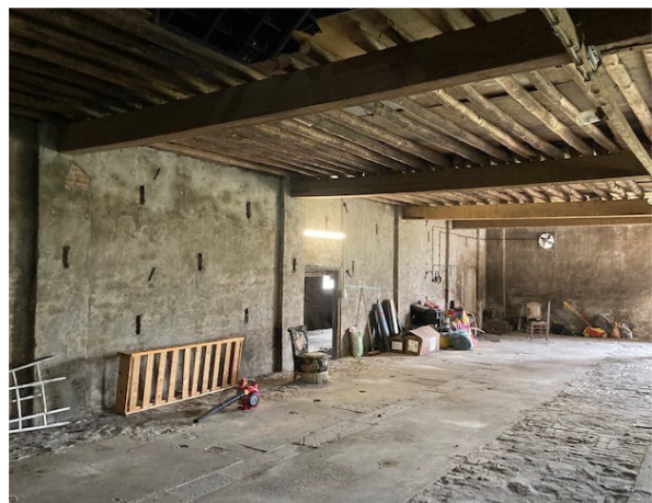
Ventilatiesluiven in de tussengevel met de varkensstal. Deze was oorspronkelijk een buitengevel.
