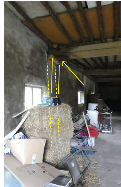
Scheefstaande muur en ingerotte balkkop.
