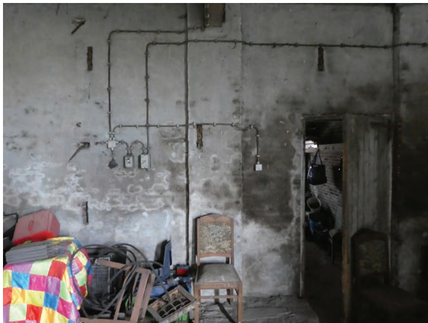
Zuidzijde van scheidsmuur met toegevoegd electrawerk.
