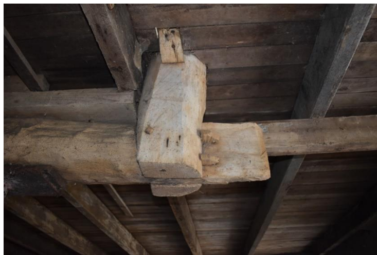
Afgezaagde gebintstijl van het ankerbalkgebint.
