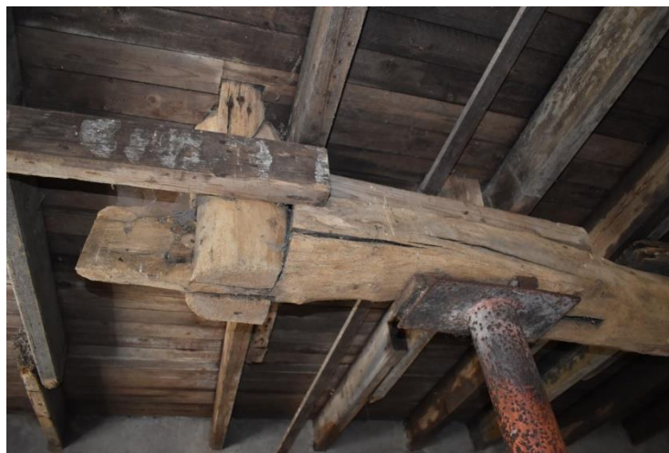
Afgezaagde gebintstijl van het ankerbalkgebint.
