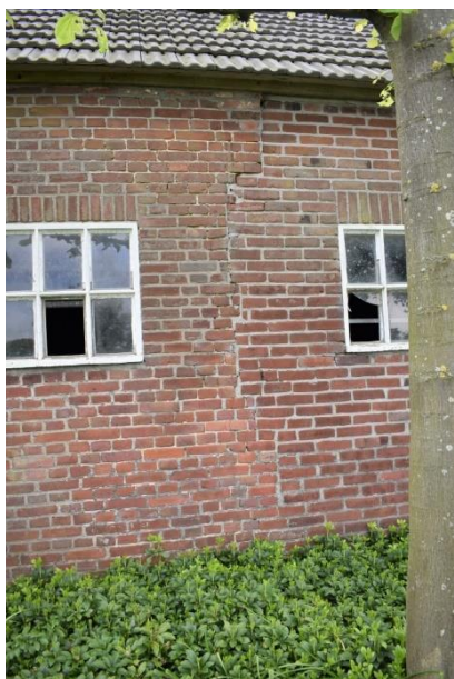
Bouwnaad tussen oud (links) en nieuw (rechts) metselwerk.
