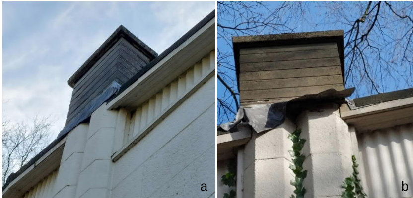
Figuur 4a & 4b: De openingen onder het daklood respectievelijk bij de woningen met huisnummer twee (a) en acht (b).
