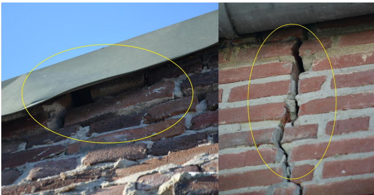
Figuur 6 Links ruimte onder de dakrand en ruimte door het ontbreken van een baksteen. Rechts scheur in de muur waardoor vleermuizen de spouw kunnen bereiken.
