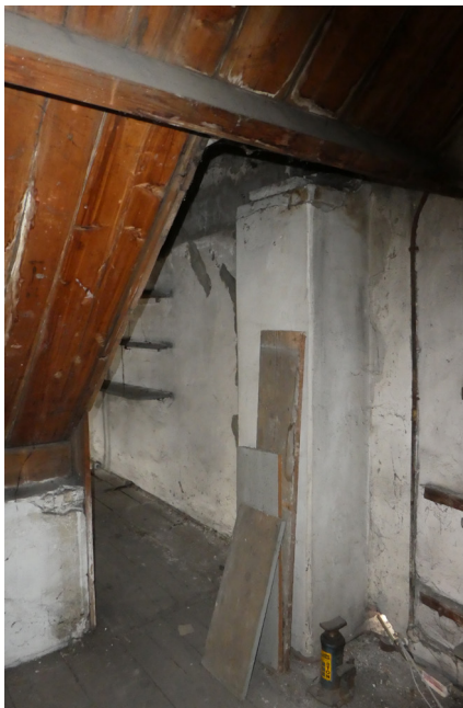
Rookkanaal op zolder 1.01 en doorgang naar 1.02.
