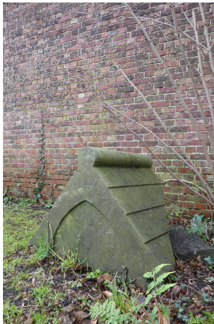
Losliggende hardstenen muurafdekking.
