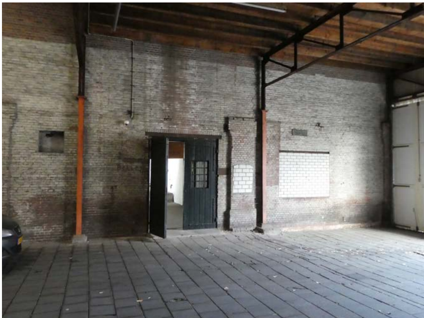
Naast de entree vanuit de opsagruimte naar de productiehal zijn twee vensters van een loket dichtgemetseld.
