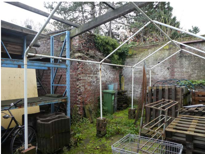
De afdekking en hoek van de muur is op onderdelen beschadigd.
