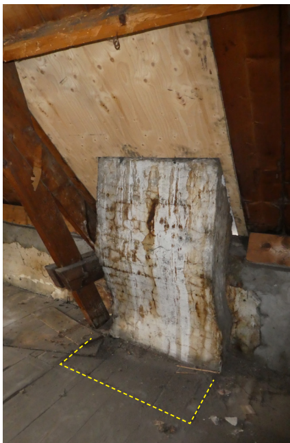
Rookkanaal op zolder 1.02.
