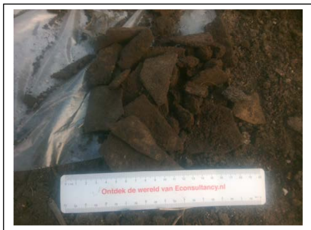
Foto 19. Asbestplaatmateriaal asbestinspectiegat A17
