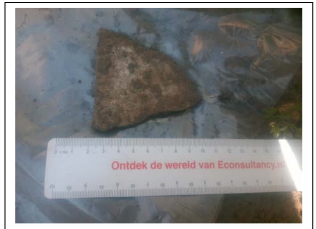
Foto 16. Asbestplaatmateriaal asbestinspectiegat A15
