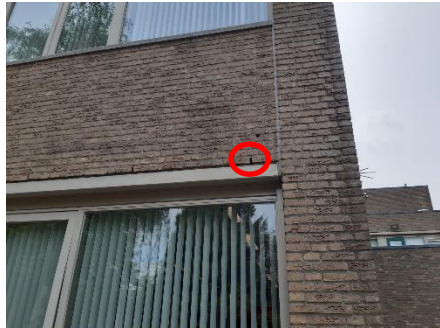
Figuur 4.3 open voegen in het gebouw aan de Apennijnenweg 9.
