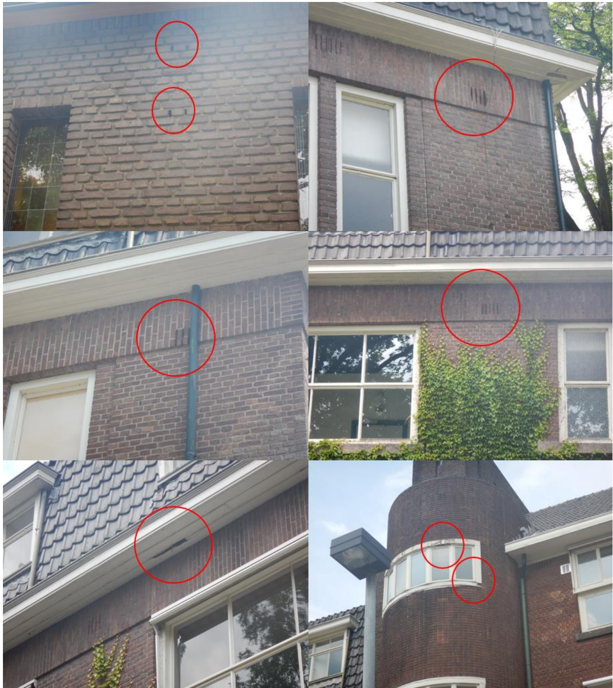
Twee paar open stootvoegen (linksboven), open stootvoegen met bijen- / wespennest (rechtsboven), open stootvoegen met bijen- / wespennest naast regenpijp (links- en rechtsmidden), opening in afwerking dakgoot (linksonder) en openingen in kozijnen (rechtsonder).
