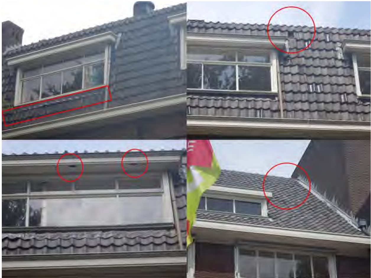
Openingen in de afwerking onder het kozijn (linksboven), opening in de dakbedekking (rechtsboven), opening in het houtwerk van de dakkapel (linksonder) en losliggende dakpannen (rechtsonder).
