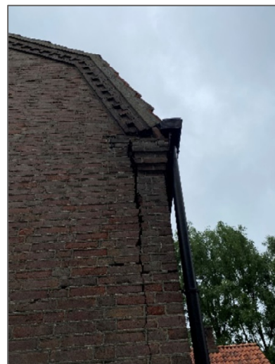
Afbeelding 4.2: Eén van de scheuren in het metselwerk
