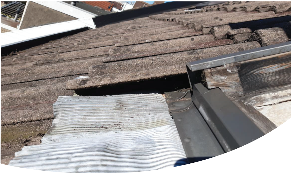
Afbeelding 3.3. Aangetroffen openingen onder enkele dakpannen op de overgang van de dakpannen naar het kozijn van het kantelraam.
