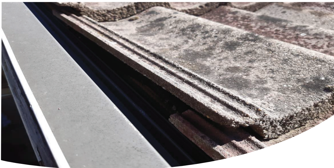
Afbeelding 3.4. Aangetroffen openingen onder enkele dakpannen op de overgang van de dakpannen naar het kozijn van het kantelraam.
