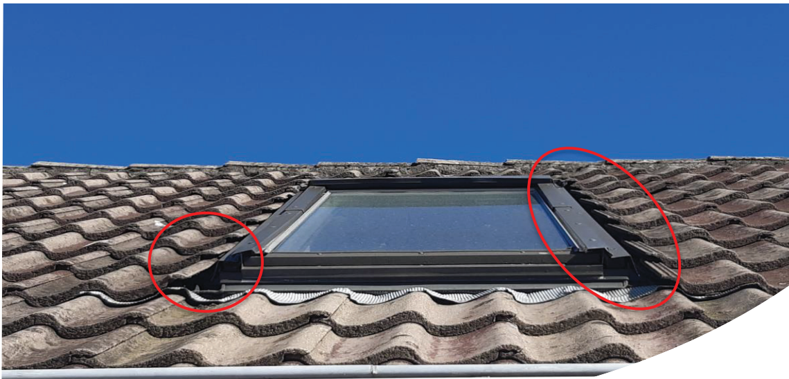
Afbeelding 4.1. Aangetroffen openingen die kunnen fungeren als zomer- en/of paarverblijfplaats voor gebouwbewonende vleermuizen als gewone en ruige dwergvleermuis.
