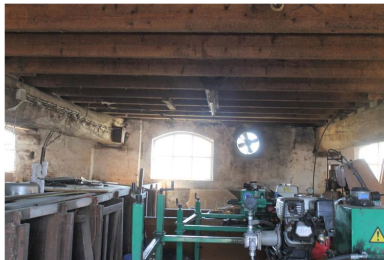
Rondhouten balkconstructie afdragend in voorgevel.
