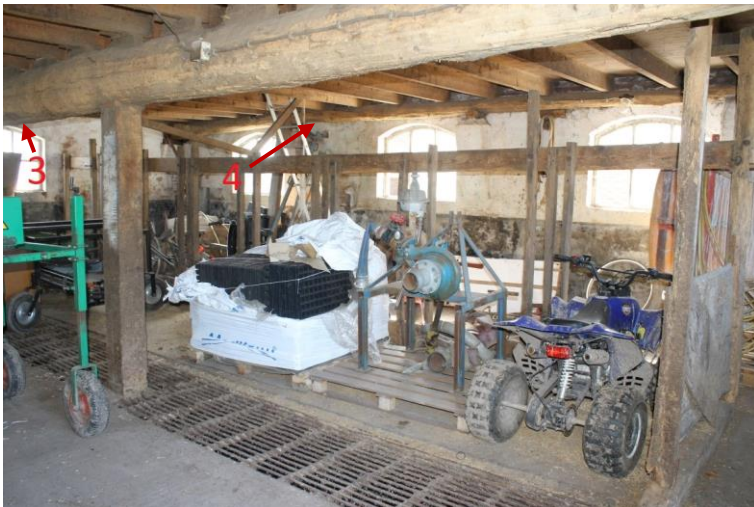
Links de zware rondhouten balk (3) en rechts de minder zware (4), beide balken bevinden zich rechts van de verwijderde dwarsdeeldeuren (niet zichtbaar op de foto).
