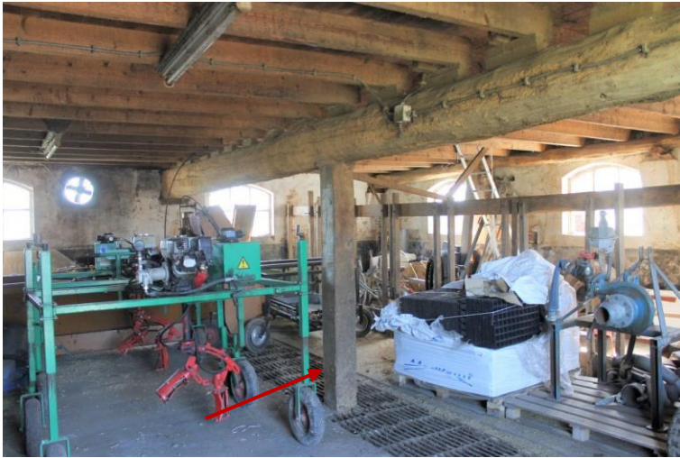
Linker balk met later aangebracht extra ondersteuning (zie pijl).
