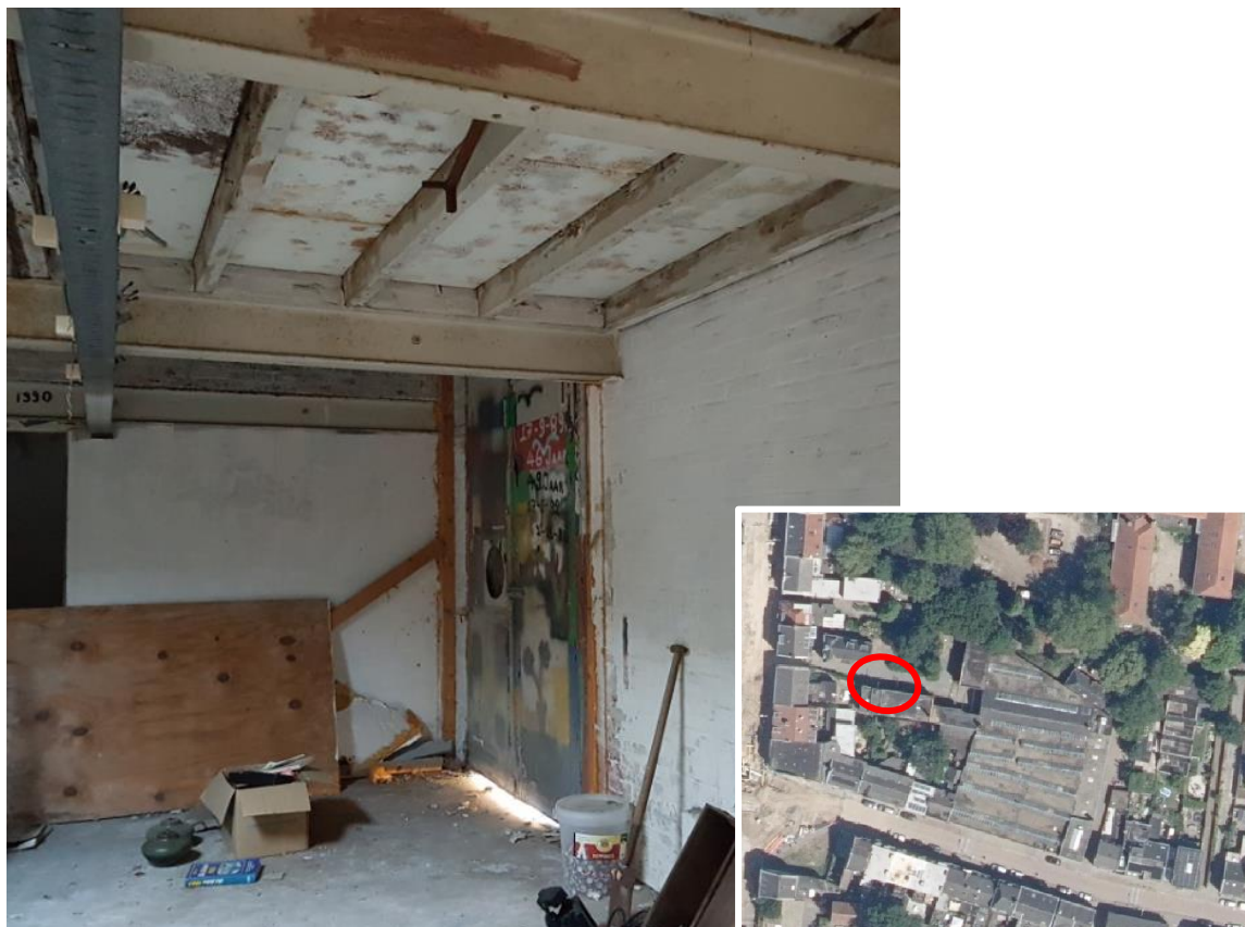
Figuur 5. Opening in het westelijke pand die vleermuizen toegang kan bieden. De rechterafbeelding geeft de locatie binnen het projectgebied weer.
