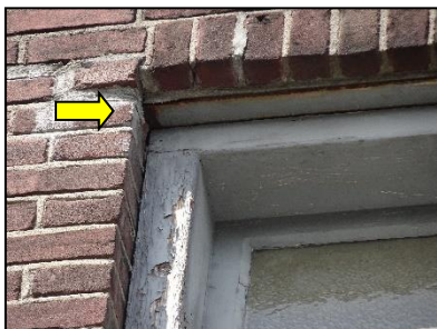
Figuur 18. Ruimte langs de raamkozijnen van het leegstaande pand.
