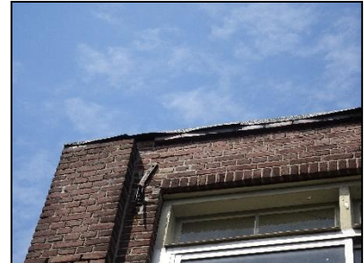
Figuur 17. Ruimte onder de loszittende dakbedekking van het leegstaande pand.
