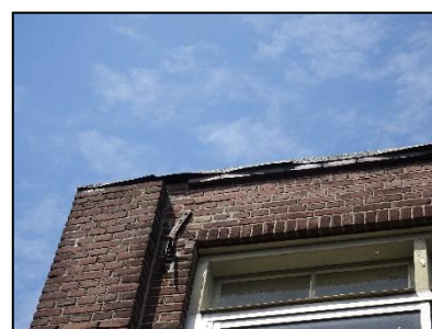
Figuur 16. Ruimte onder de loszittende dakbedekking van het leegstaande pand.
