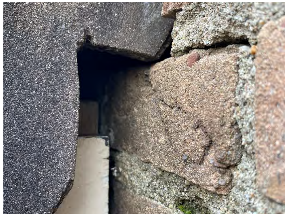
Figuur 15. Op een enkele plek zijn er openingen tussen de daktegels en het gebouw. Hier kunnen mogelijk verblijfplaatsen van vleermuizen worden verwacht.
