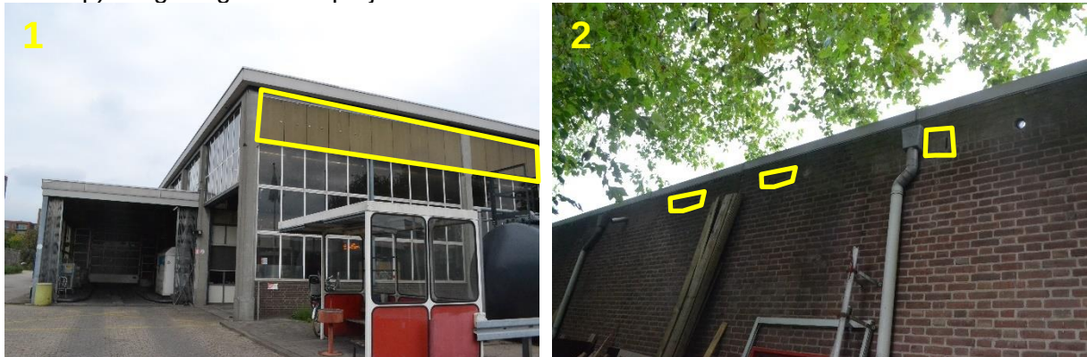
Figuur 3.2: De ligging van geschikte verblijfplaatsen voor vleermuizen in ter plaatse van de geel gemarkeerde locaties. Het betreffen platen, stootvoegen en gaten in de muur. De cijfers verwijzen naar de locatie van de foto zoals weergegeven in figuur 3.4.
