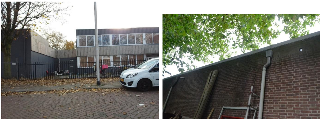
Figuur 3.1 Weergave locaties zomer- en paarverblijven gewone dwergvleermuis La Poubelle ter plaatse van de zijde Havendijk bij de betimmering (links) en de achterzijde bij de stootvoegen (bij regenpijp).
