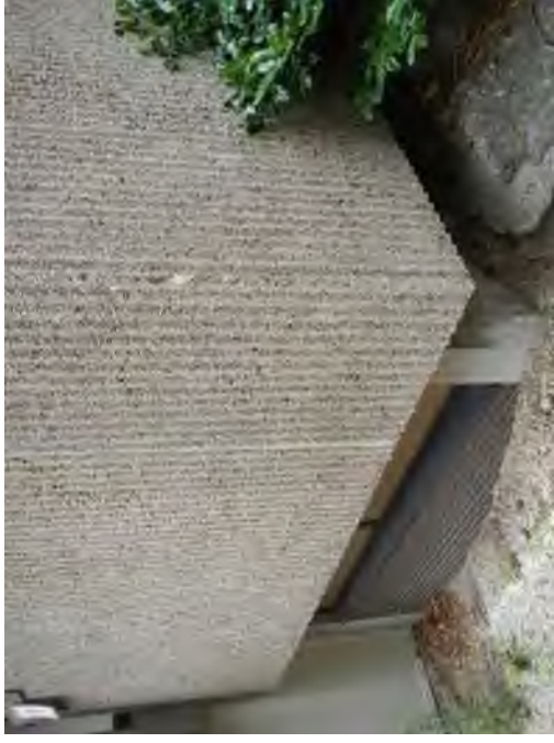
Foto 51: Geb.1, asbestvrije kit (grijs) tussen elementen (M102-V)
