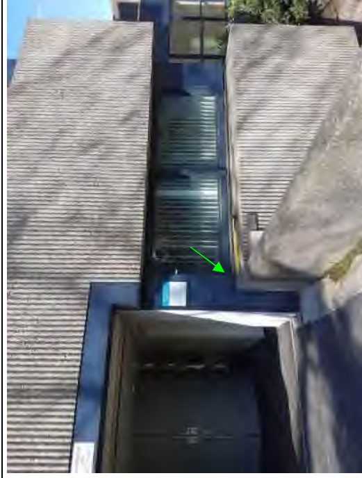
Foto 78: Geb.1, kit aan zijkant waterslag achter gevelbetimmering (M208-V)
