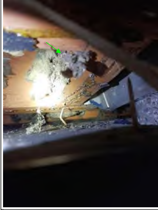
Foto 79: Geb.1, kit aan zijkant waterslag achter gevelbetimmering (M208-V)
