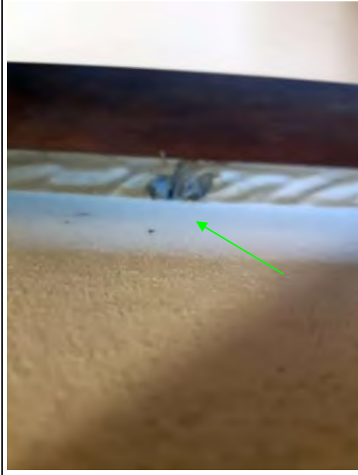
Foto 77: Geb. 1, kit langs gevelkozijn (M204-V, M205-V)
