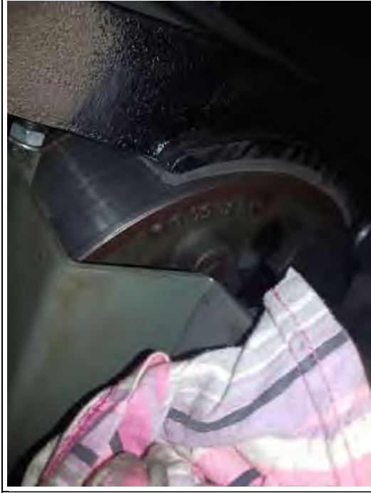
Foto 85: Geb.2, pakking in remschoenen liftmotor (M229-V)
