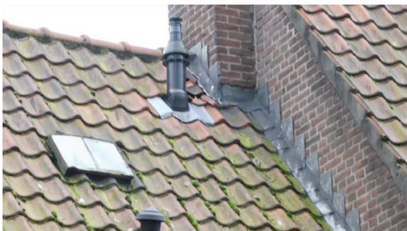
Kieren en spleten tussen dakpannen en loodflappen
