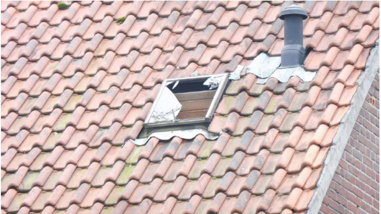
Afbeelding 6: Een kapot dakraam zorgt voor een slechte isolatie en maakt het gebouw nog ongeschikter als winterverblijfplaats. Tevens is de cementen afdichting langs de dakrand te zien, dit bemoeilijkt de toegang voor de vleermuizen, naast de schoorsteen is wel een potentieel geschikt toegang onder een opstaande dakpan.
