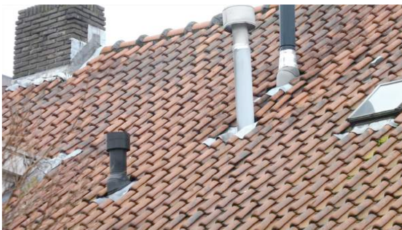
Afbeelding 5: Potentie voor gierzwaluw op plekken waar de dakpannen niet goed op elkaar aansluiten.
