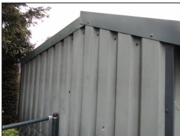
Figuur 10. Geen toegang onder de golfplaten voor vogels.
