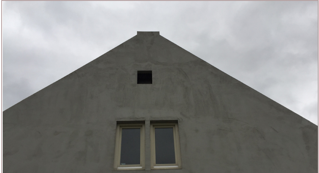
Foto 1 Vernieuwde gevel (buiten- schil) met aangebrachte opening voor de kerkuil.
