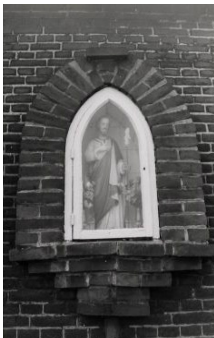
Afb. 11 en 12 In detail de nis die in de twintigste eeuw aan de stalgevel is toegevoegd. Baksteen en voegwerk wijken duidelijk af van het negentiende-eeuwse metselwerk van de gevel. Op de oude foto rechts is het heiligenbeeld nog aanwezig.
