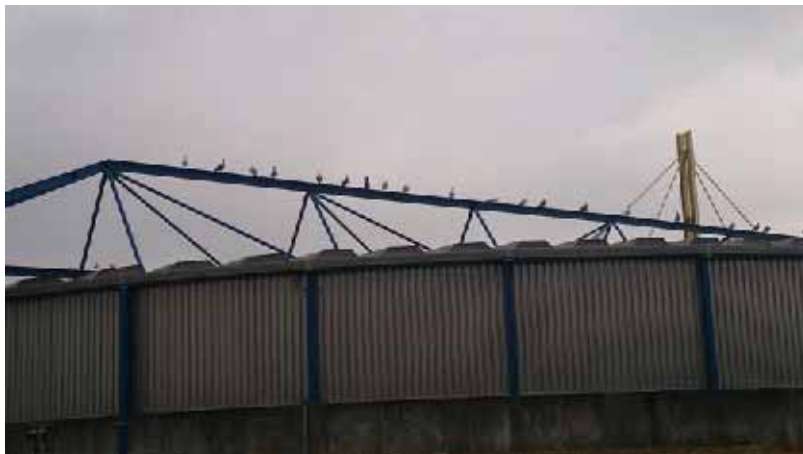
Rustplaats meeuwen op warmwaterleidingen waterzuivering.
