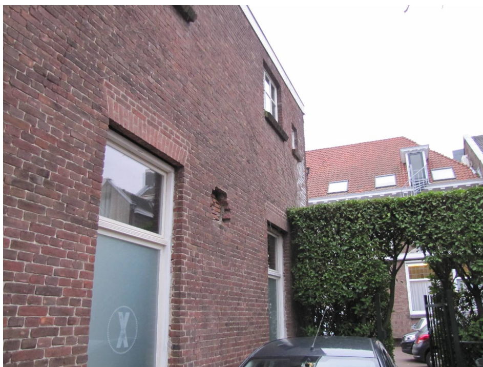
Afbeelding 2. Spleet tussen raamkozijn en buitenmuur.
