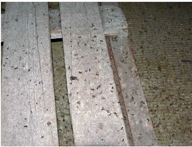
Uitwerpselen van vleermuizen op de kapelzolder.
