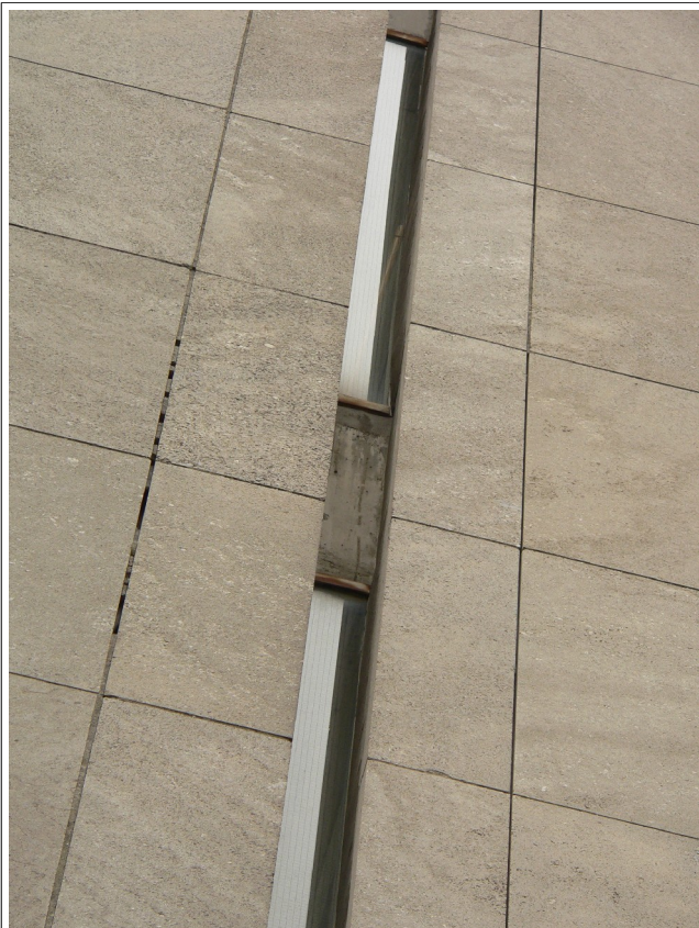
Gevelplaten aan de zuidkant van de hoogbouw van Wethouderslaan 9. Schade aan voegwerk geeft vleermuizen toegang tot kieren achter deze platen.
