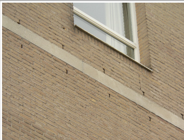
Open stootvoegen in hoogbouw Wethouderslaan 9
