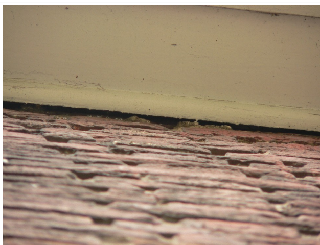
Toegang tot daklagen en spouwmuren via kierende daklijsten.
