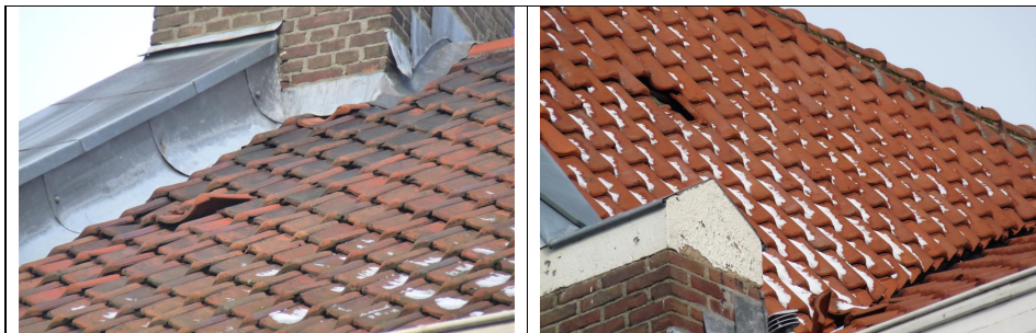
Figuur 3.1. Enkele scheef liggende dakpannen. Deze kunnen toegang bieden tot verblijfplaatsen van vleermuizen.
