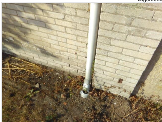
Koelloods links, PVC hemelwaterafvoer
