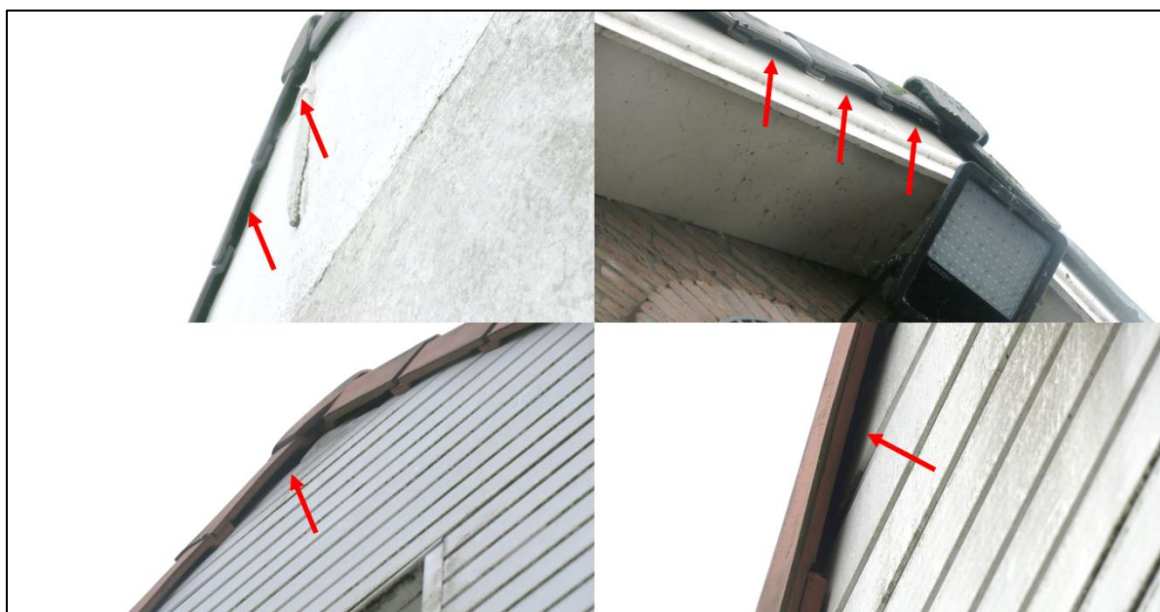
Figuur 3.1 Aan de achterzijde van het gebouw bevinden zich meerdere kleine daken met kierende kantpannen en nokvorsten die vleermuizen toegang kunnen verlenen tot de open dakruimte en/of spouw.
