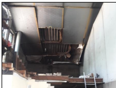
Figuur 7. Kapotte plafondbeplating in de opslaghal.
