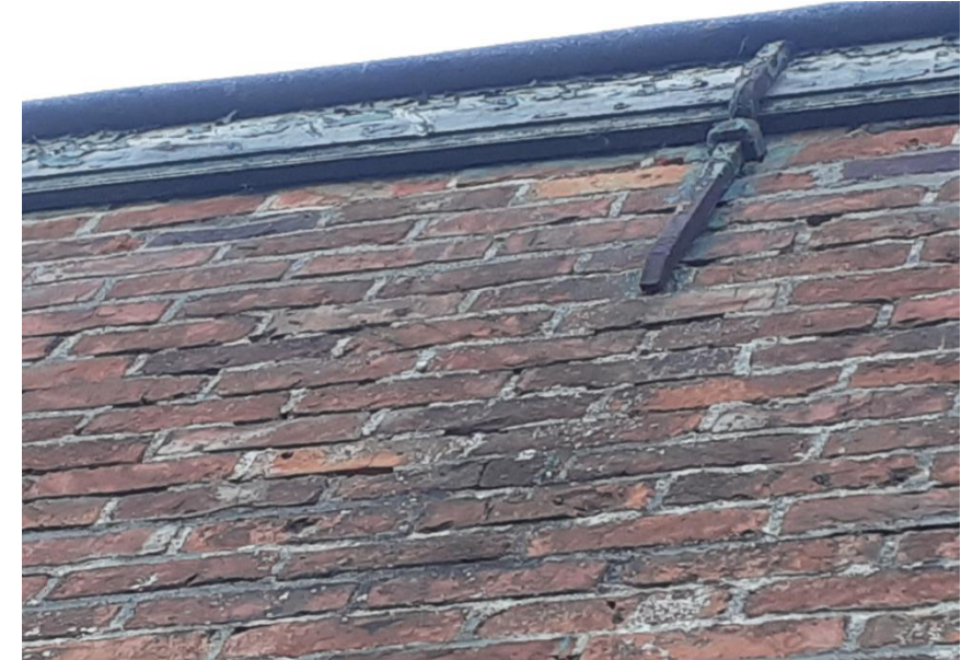
Figuur 13: Houten dakrand langs de gevel aan de Westergroenstraat
