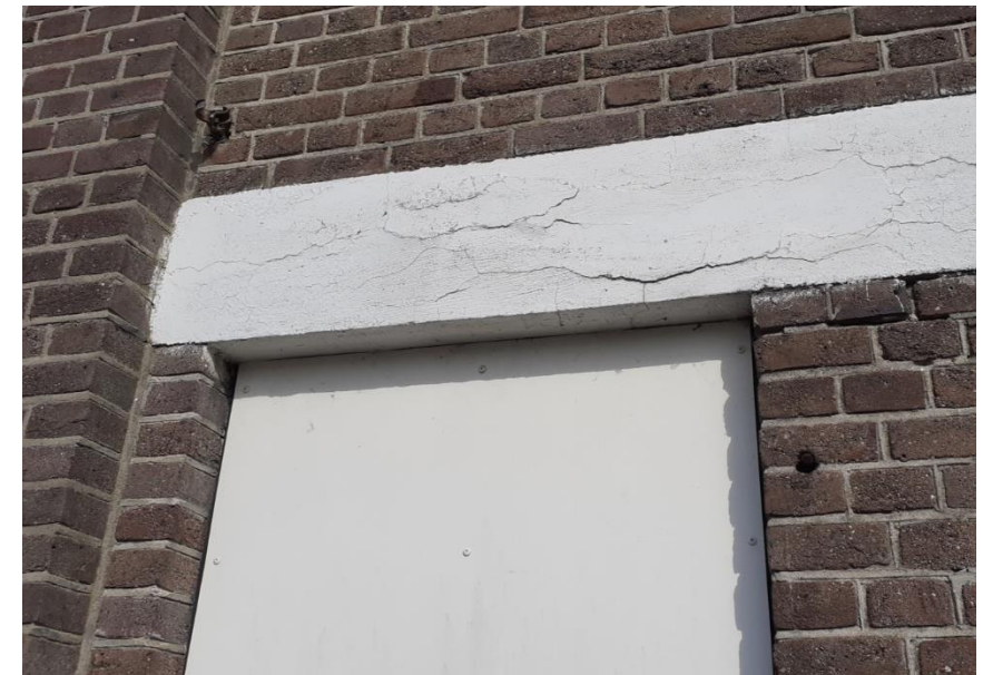
Figuur 11: Scheuren in de betonnen lateien
