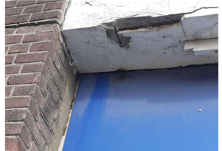
Figuur 10: Scheuren in de betonnen lateien
