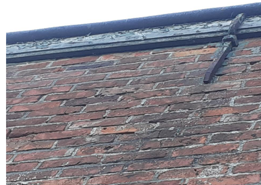
Figuur 12: Houten dakrand langs de gevel aan de Westergroenstraat
