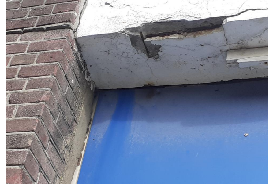
Figuur 10: Scheuren in de betonnen lateien
