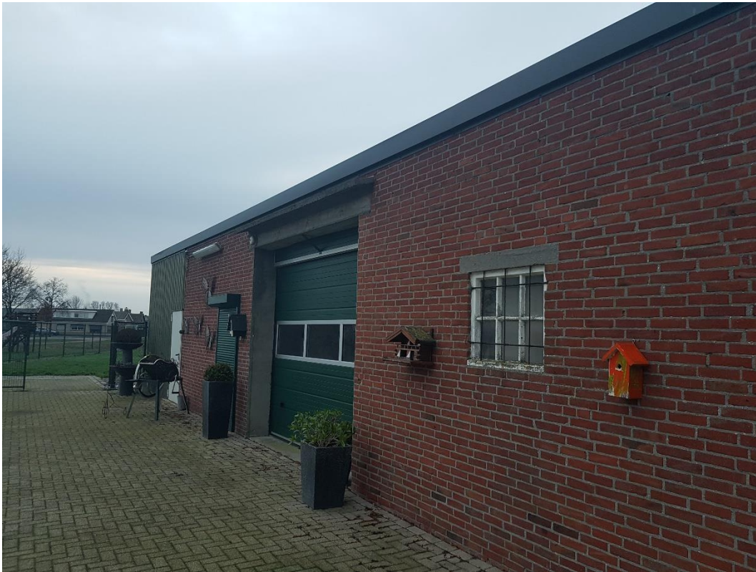
Bijgebouw 1 Geen ruimte tussen dakrand en muur.
