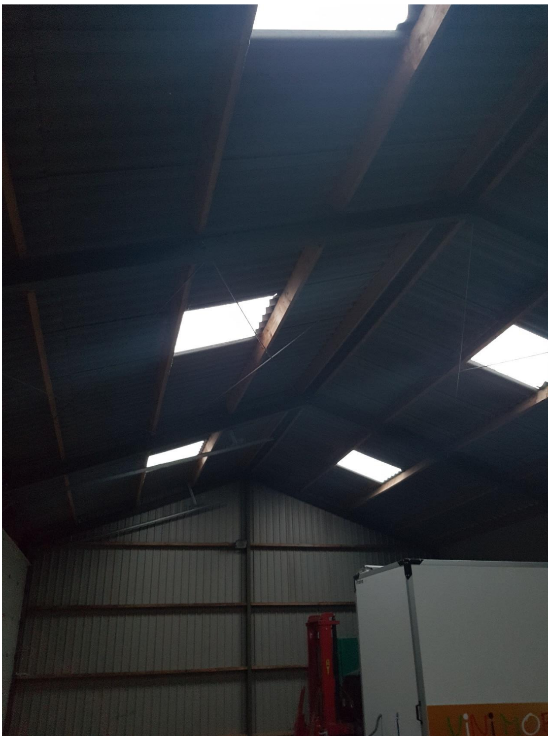
Bijgebouw 2 Niet geschikt als verblijfplaats voor vleermuizen doordat de gladde damwanden geen grip bieden en er geen wegkruipmogelijkheden zijn.
