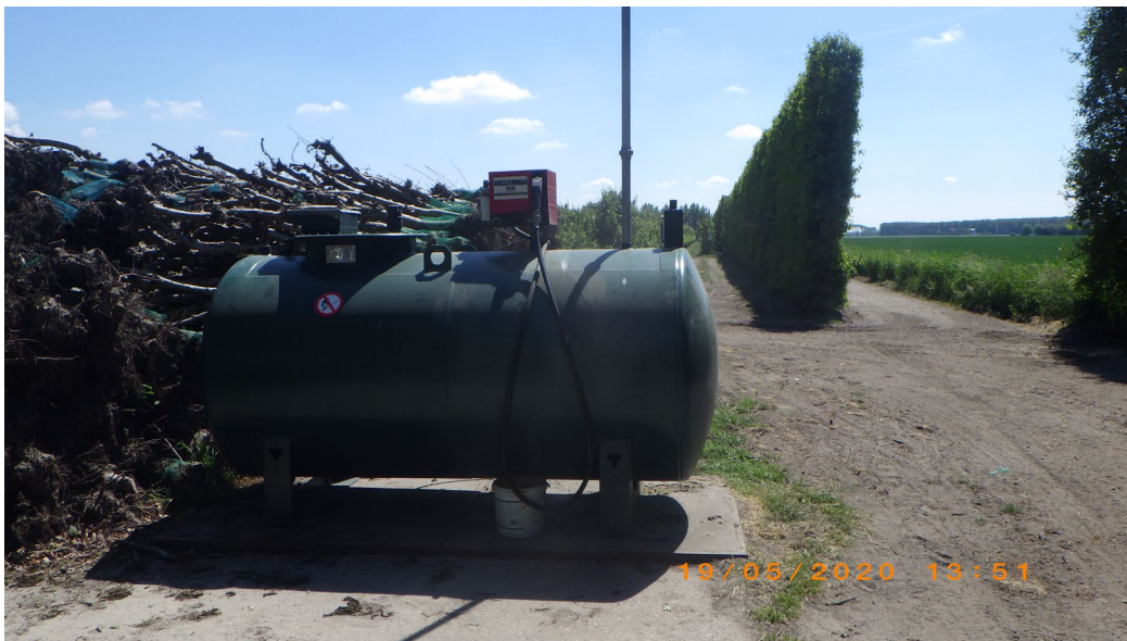
Figuur 2.4: Foto bovengrondse tank
