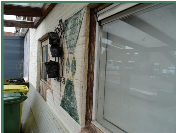
Strak aansluitende kozijn en deurpost
