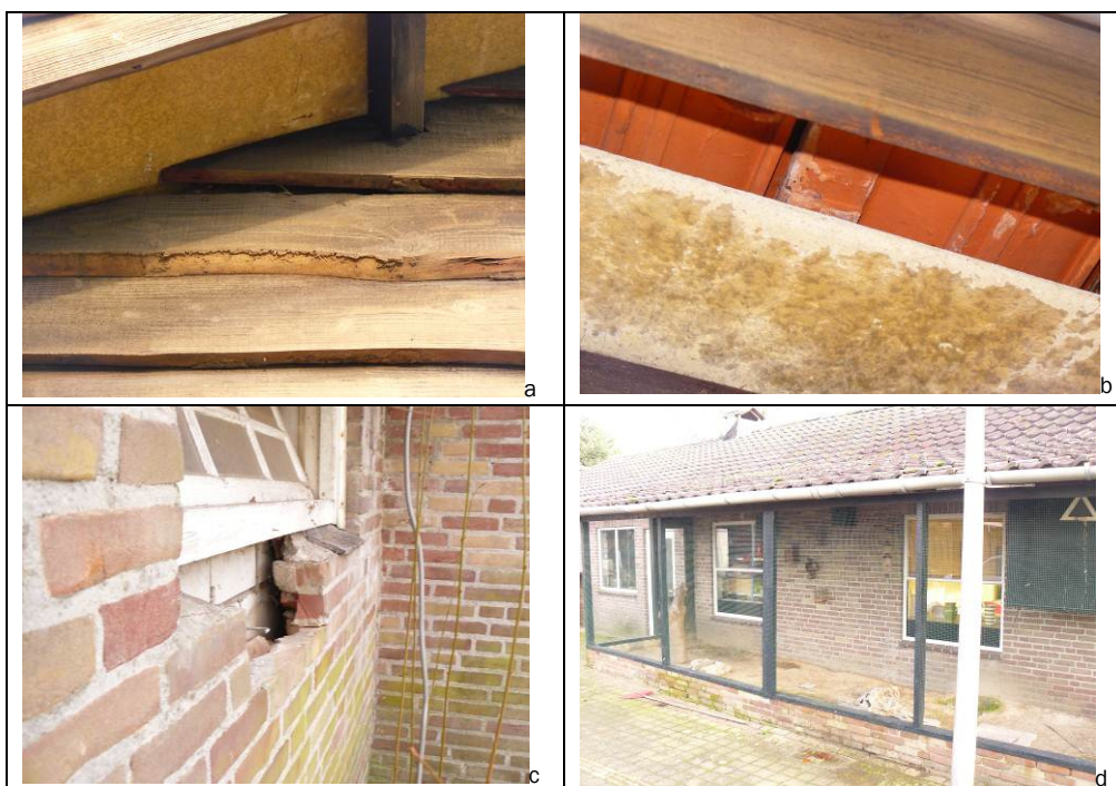
Figuur 8. Details van de voormalige paardenstal a) houten beschotting op de voorgevel, b) de ruimte tussen de platen en het pannendak, c) beschadiging in de buitenmuur, d) volière aan de zijkant van de schuur.
